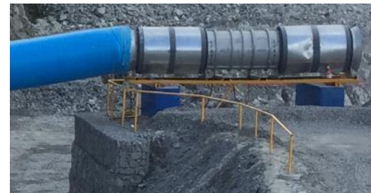
CC1400(2X150) kW VENT FAN
