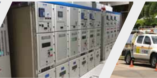
RU DATA CENTRE
