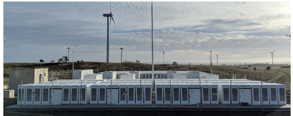
Lake Bonney Battery Energy Storage System, SA
