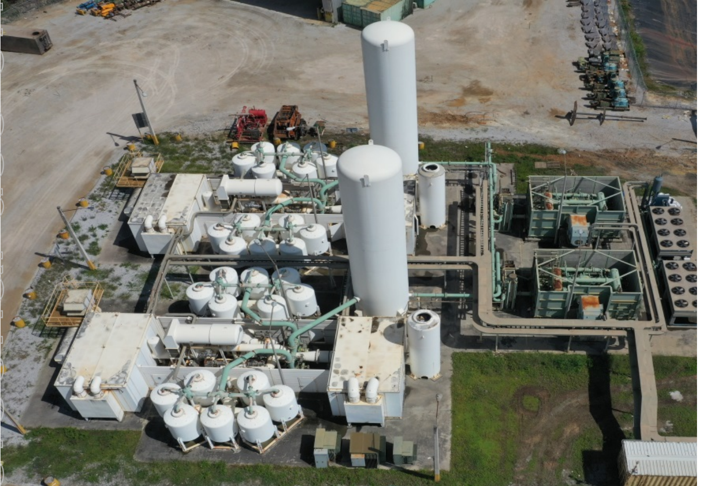
Las Lagunas Oxygen Plant
